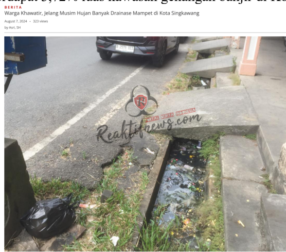
Gambar 3. Kondisi eksisting salah satu drainase di Kota Singkawang
